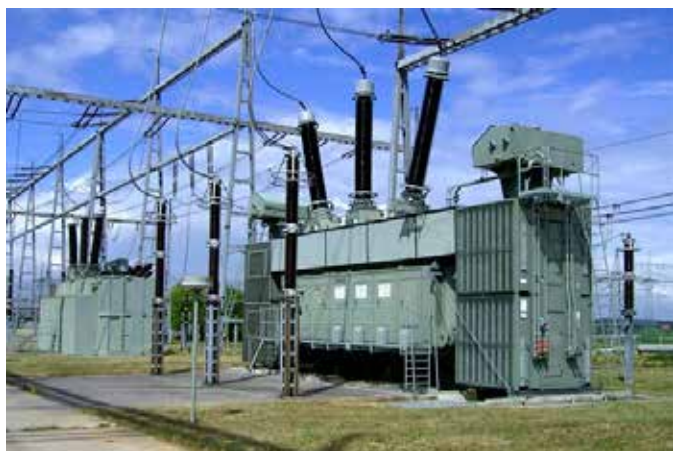
Poste de transformation électrique
