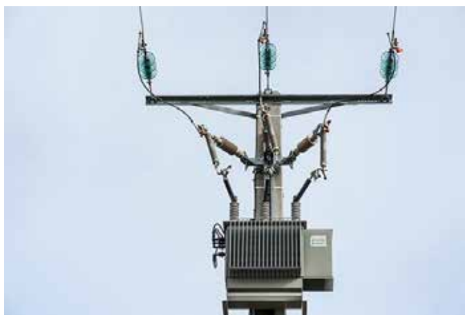
Transformateur moyenne tension – basse tension
